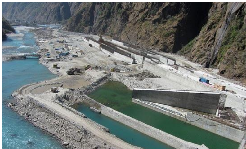
中国水电建设集团国际工程有限公司承建的上塔马克西水电站
